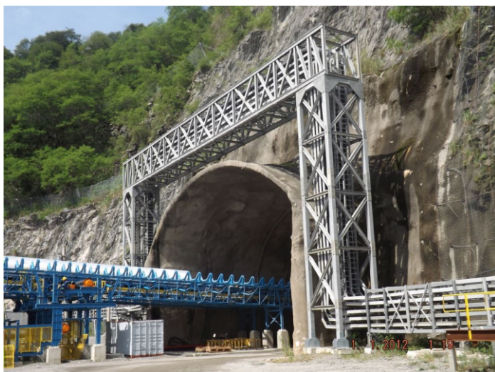
Cabla Rack do Porto Sudeste - 40m de vão livre
