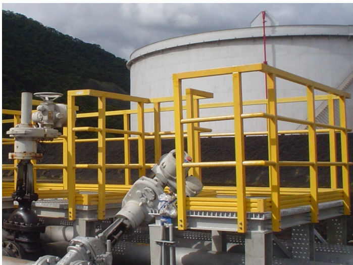
Petrobrás - Plataforma de Acesso a Instrumentação
